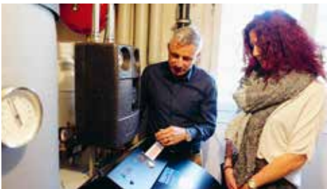
Meist ist eine gründliche Abklärung, welches Heizsystem das passende ist, nur über eine persönliche Beratung im Heizungskeller möglich.
